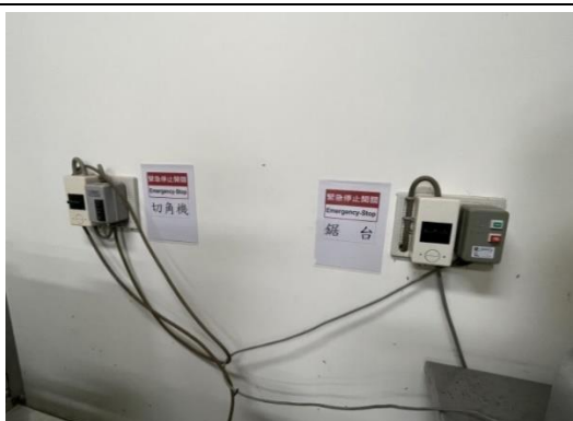
動物產品推廣中心加強緊急斷電開關標示
