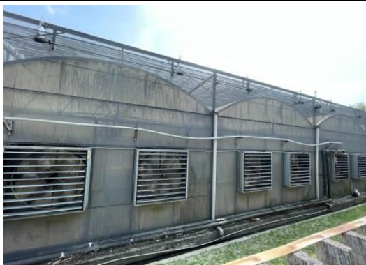
園藝技藝中心溫室大型風扇接地
