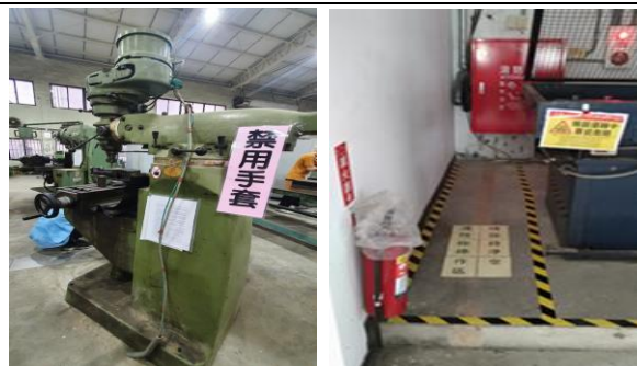
改善:1.已標示明顯的禁用手套警語 2.消防栓前方標示區隔線，並張貼警示標語-消防栓操作區，請保持淨空
