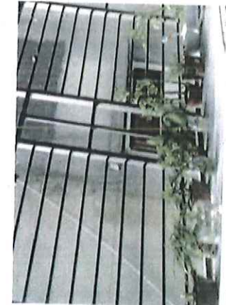
圖1-6 鐵欄杆阻逃生
