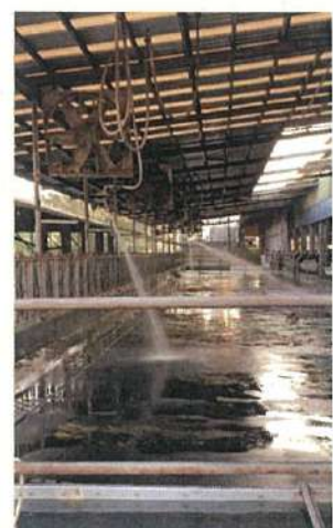
自動噴洗設備
