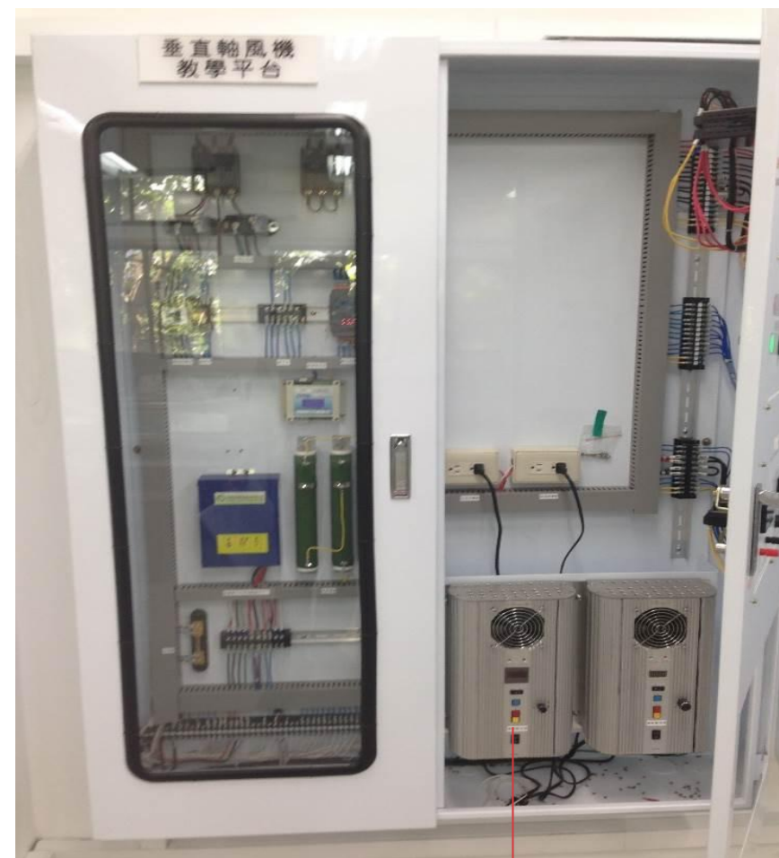
交直流電壓轉換(逆變器)透視區
