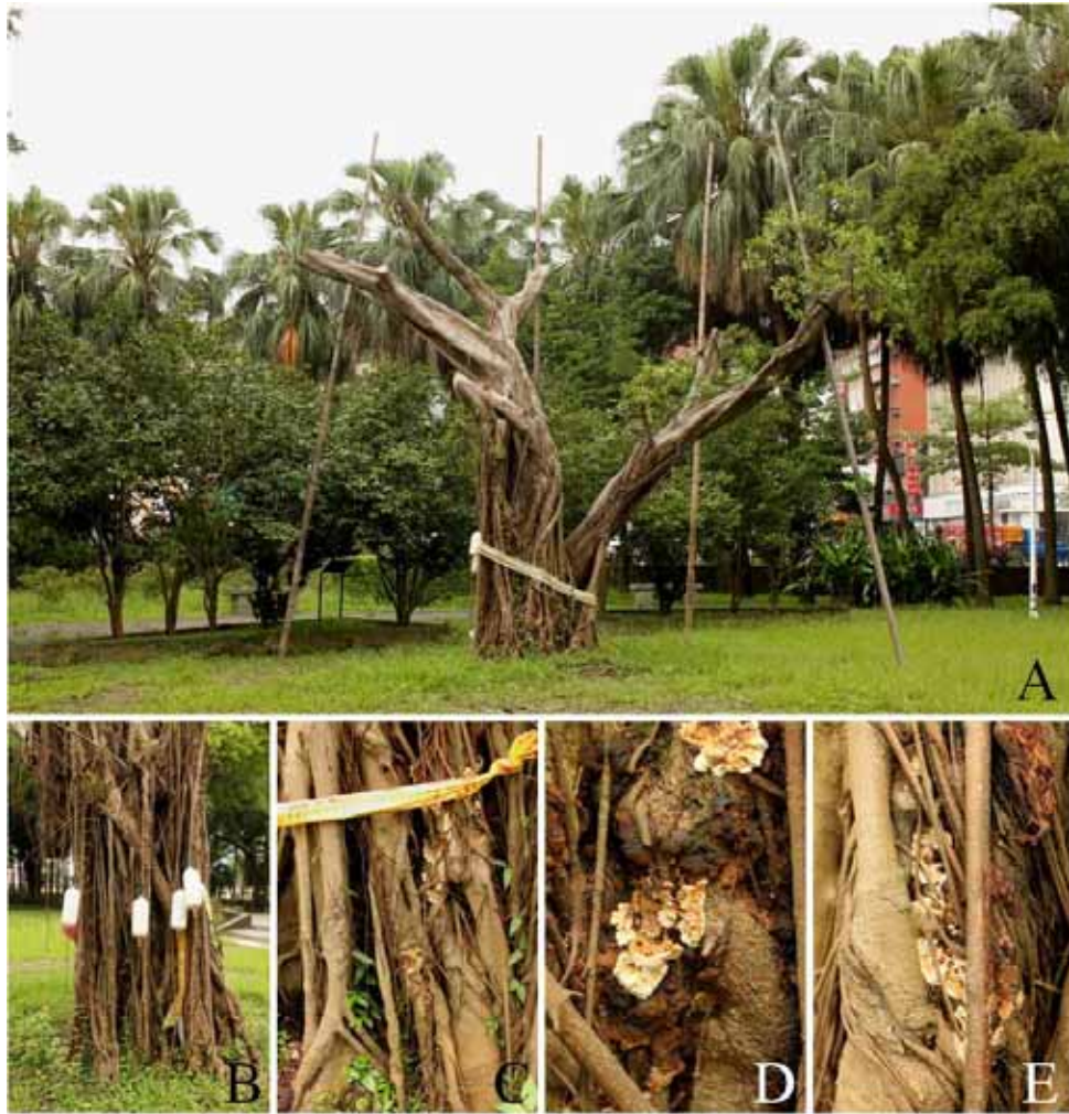
圖五、傳園鄰接之 30 年生正榕，已以藥劑灌注防治，為防止強風或豪雨浸潤倒塌，進行末端枝幹修剪，維持樹基樹冠平衡，並設立安全支架以及警示標識，其後又歷經多次颱風、豪大雨侵襲，但仍然屹立挺拔，並逐漸恢復生機(A、B)(2012 年 6 月);以及瓦斯火焰噴槍燒灼碳化散佈於莖部、莖基部之菌絲層(C、D、E) (2012 年 7 月)。
