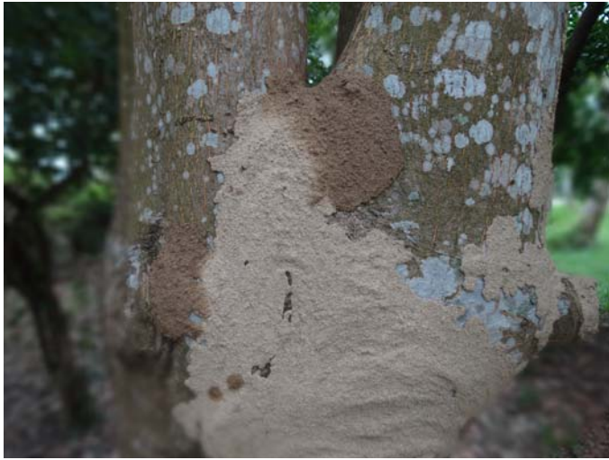
照片一、白蟻蟻道，若有濕潤的土隧道時，表示該處有蟻巢。
